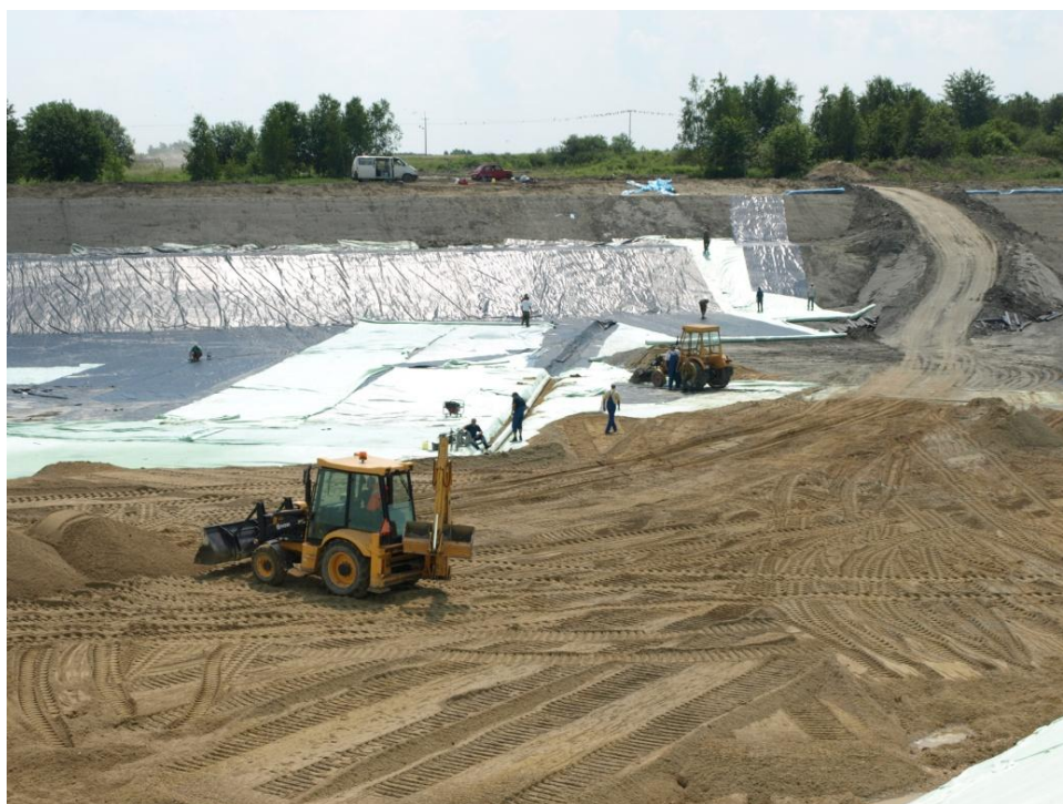
Fot. Nr 4. Składowisko odpadów w Kozodrzy
